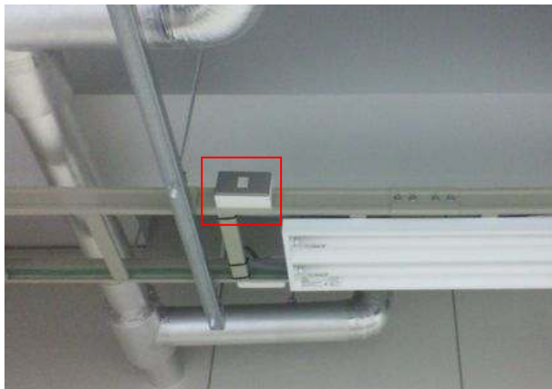
図-7 天井ラック上の LAN 接続口
