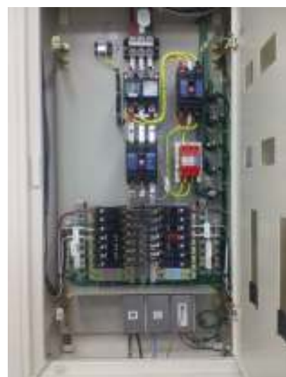
下部電源 BOX
