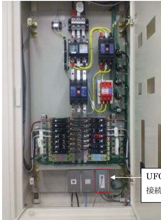
図-5 下側電源 BOX 内 UFO 館内電話
